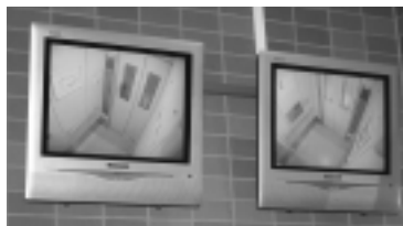
ロビーにエレベーター内部が分かるモニターを設置
